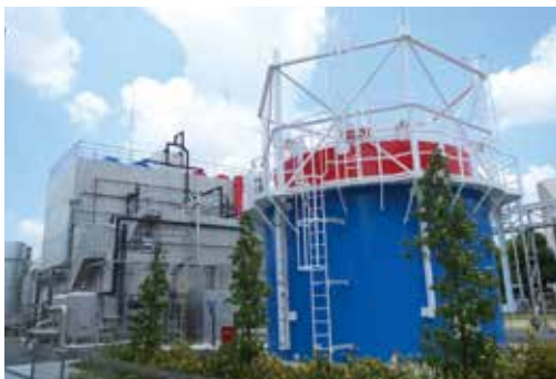
「甘水（かんすい）エコロジープラント」を導入した安田工場（大阪市）。石鹸の製造で生じる廃液（甘水）の有機物からバイオガスを回収、工場のエネルギー源として使用する日本初のシステム
